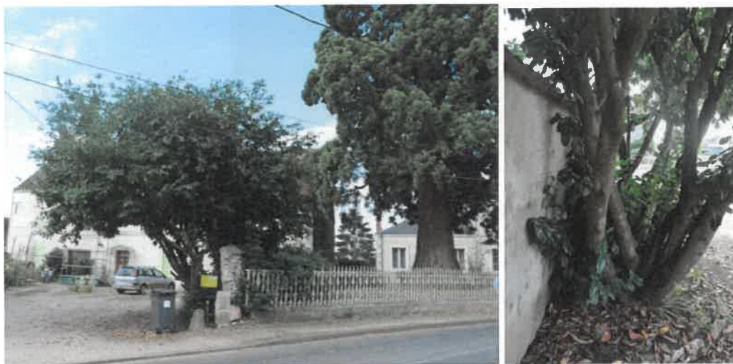
Prunus laurocerasus qui fissure le mur près de la mairie
